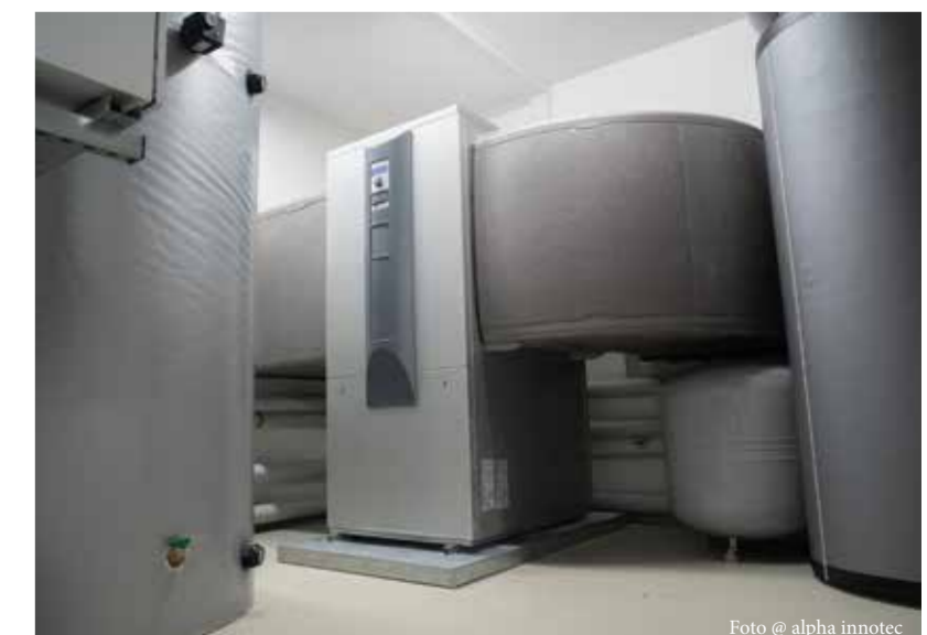
Luft-Wasserwärmepumpe LW 180 zur zentralen Wärmeversorgung eines Mehrfamilienhauses
