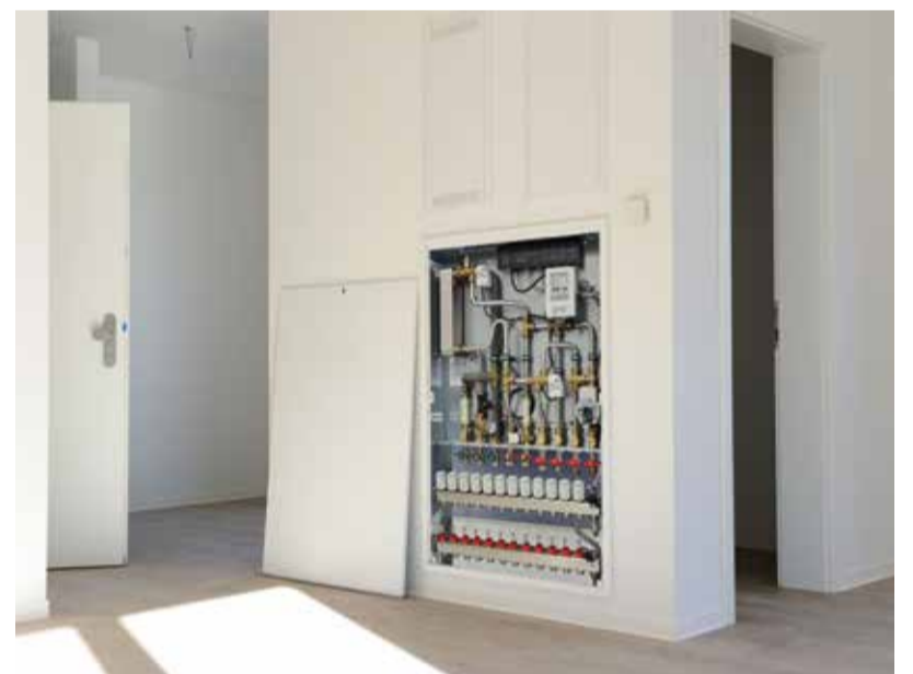
ClimaLevel W-Station mit Heizkreisverteiler
