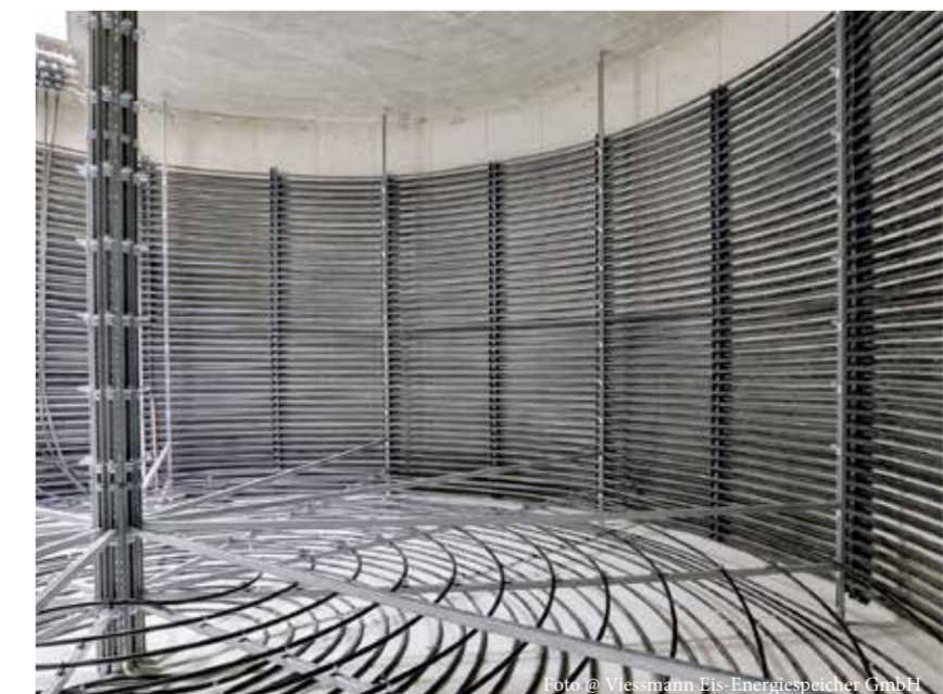
Leitungsspiralen im Eisspeicher fungieren als Wärmetauscher
